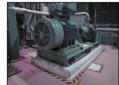
常設電動注入ポンプ
