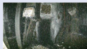
ペDESTAL開口部の状況
