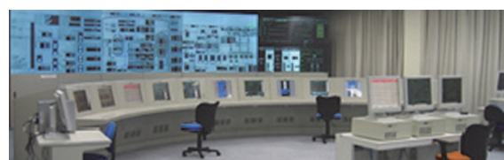
国内最新 PWR デジタル型中央制御盤シミュレータ
