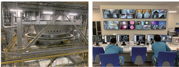
図2 中間貯蔵施設内の高温溶融による灰減容化施設 双葉町にて150トン/日規模の2施設が2020年3月竣工
