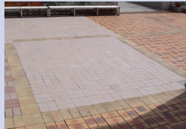
敷きブロック
