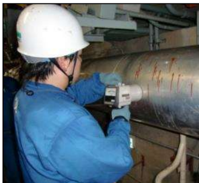
配管の線量当量率測定
