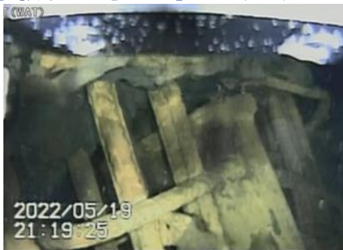
ペDESTル開口部(左側基礎部)の状況
