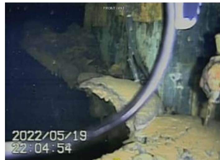
ペDESTル開口部(右側基礎部)の堆積物より上部の状況
