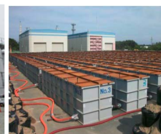
鋼製角形タンク
