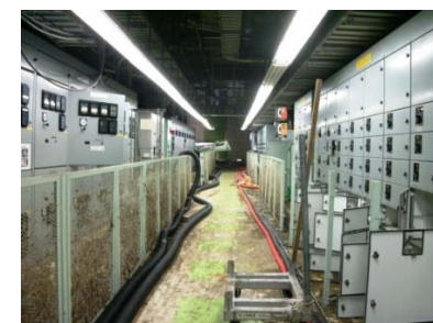
1号機タービン建屋1階電源盤
