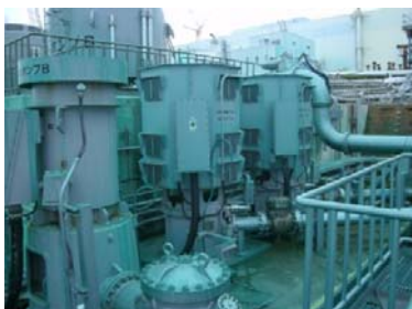
1号機格納容器冷却海水系ポンプ
