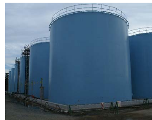
鋼製円筒型タンク （溶接）
